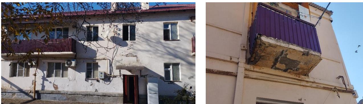
Рис. 3. Жилые дома с трещинами на фасаде
